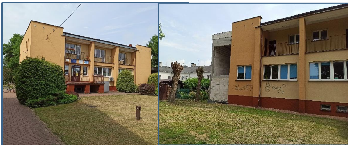
Ryc. 21. Stan techniczny budynku ośrodka zdrowia w Wiskitkach
