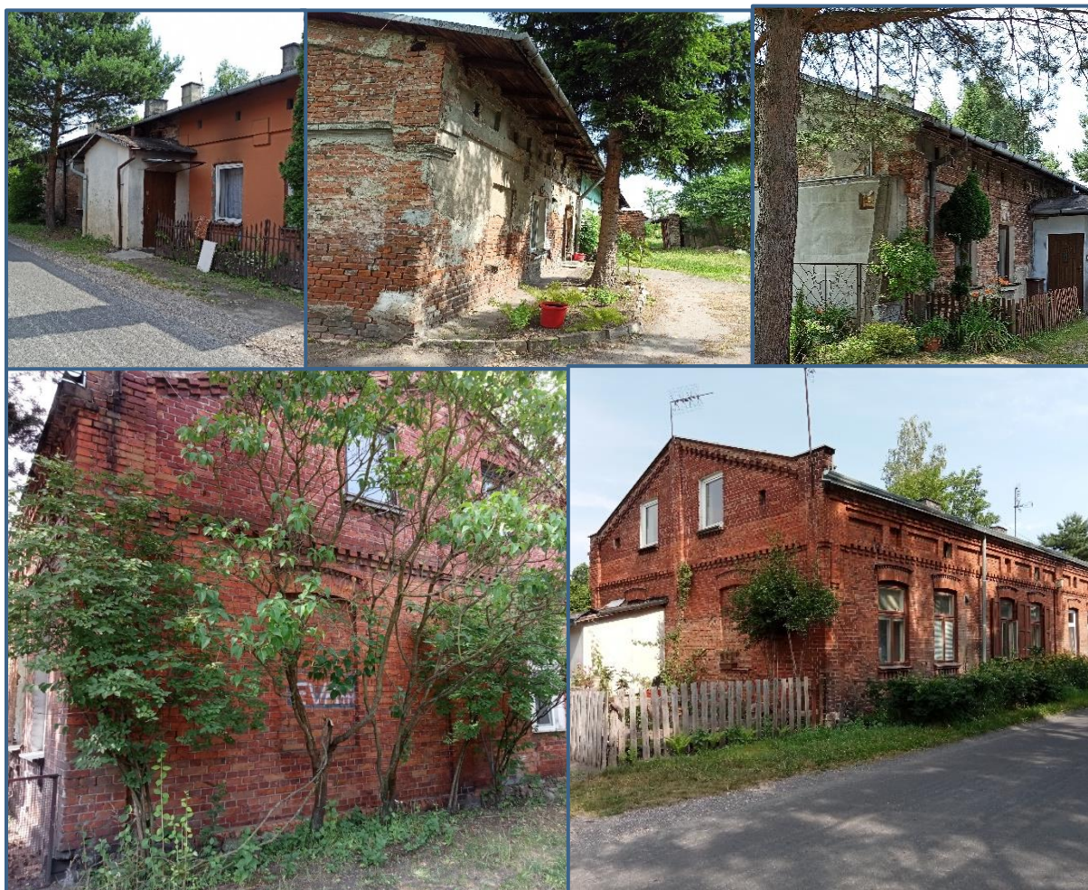
Ryc. 25. Stan techniczny budynków pełniących funkcję mieszkań komunalnych w Wiskitkach (ul. Cegielnia)
